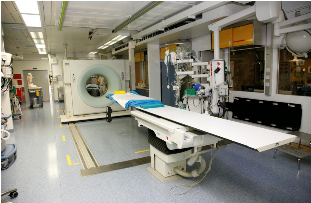
Abbildung 4. Schockraum des Wiener AKH mit fixem CT-Gerät
